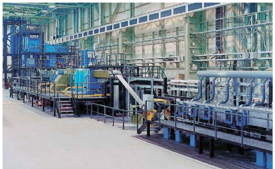
Abb. 2: Technikumshalle des Dortmunder OberflächenCentrums (DOC) mit Bandversuchsanlage
